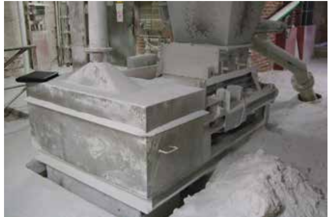
Bild 1: Die raue Umgebung stellt hohe Anforderungen an die eingesetzten Dosiersysteme in der Düngemittelindustrie. Der Aufgabetrichter, in dem das Material auf die Dosierbandwaage gelangt, ist aus Edelstahl.
