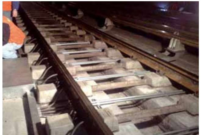
Bild 2: Fertig installierte und verkabelte Messungen
