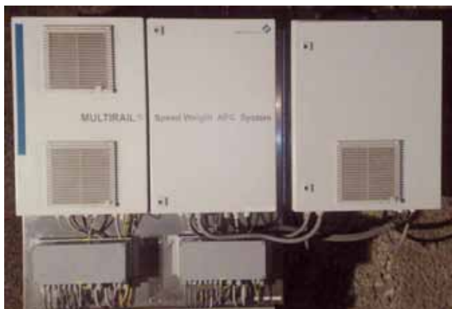
Bild 4: Auswerteelektronik im Schaltschrank
